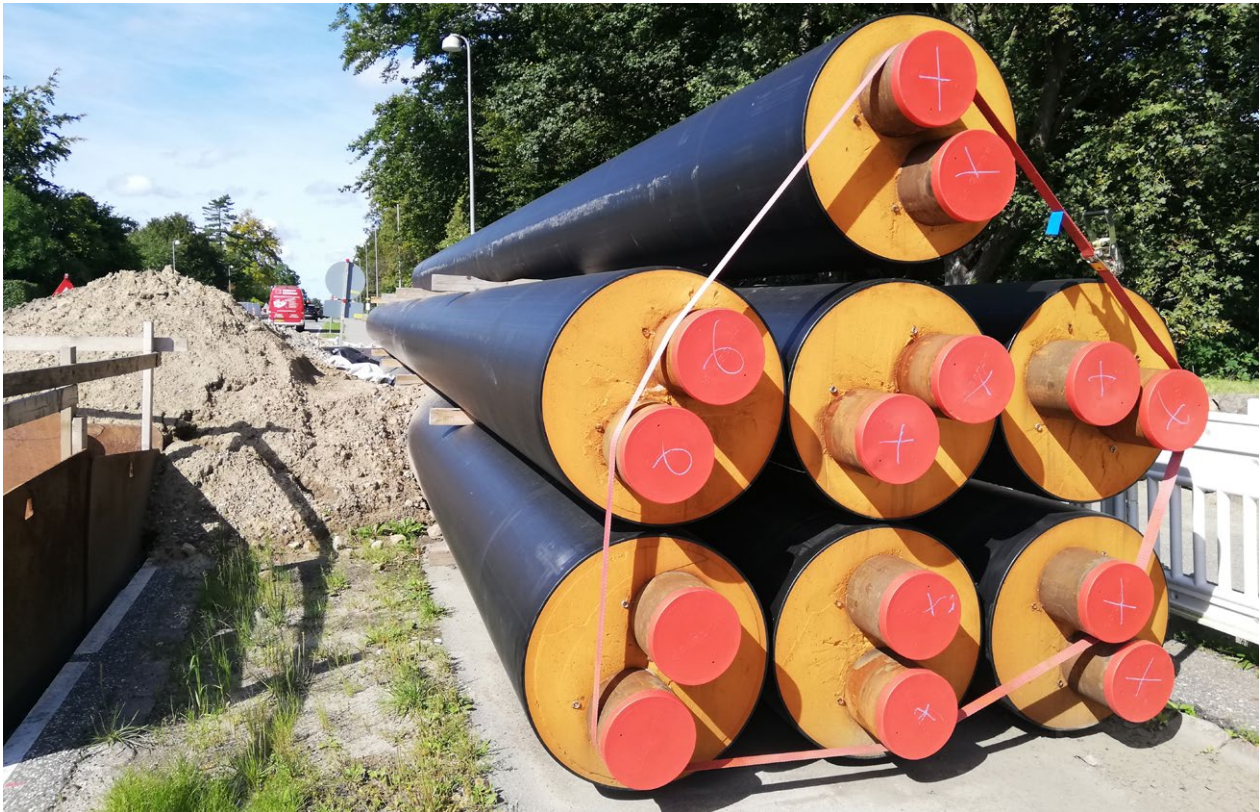
Fjernvarmerør ved Kongevejen
